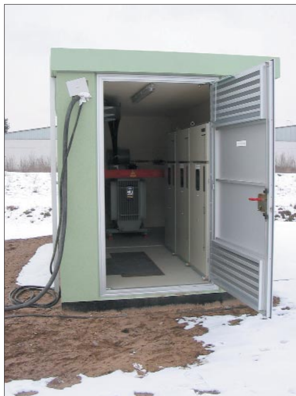
Bild 1. Station K 2000 im Netz der HSE
